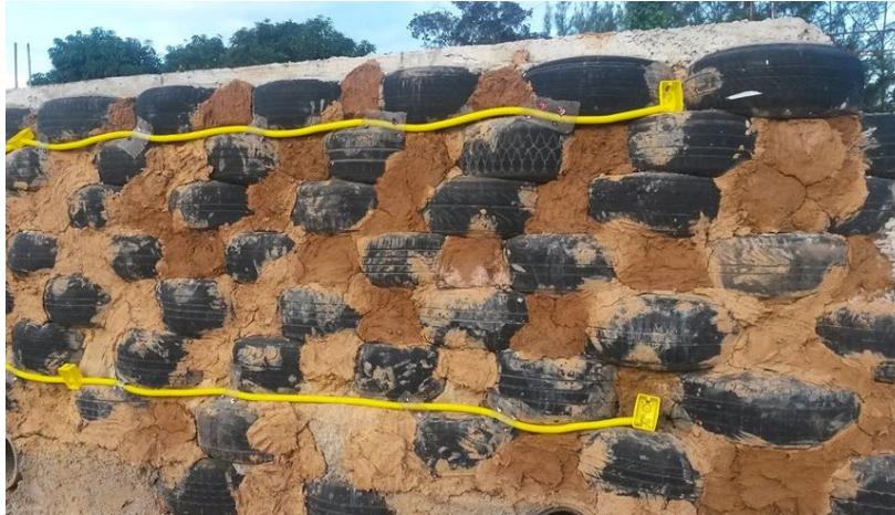
Figura 11: Instalações Elétricas sendo instaladas em alvenaria de pneus de borracha na Casa PAS.
